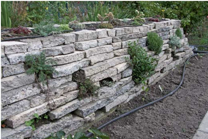
Aus Betonbruchsteinen lässt sich fast zum Nulltarif eine Trockenmauer bauen. Es sollten genügend freie Plätze zum Einsetzen der Pflanzen freigelassen werden.
