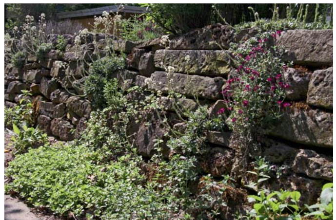
Eine Trockenmauer aus unbearbeiteten Natursteinen bietet sehr viele Hohlräume, in denen sich Tiere und Pflanzen ansiedeln können.
